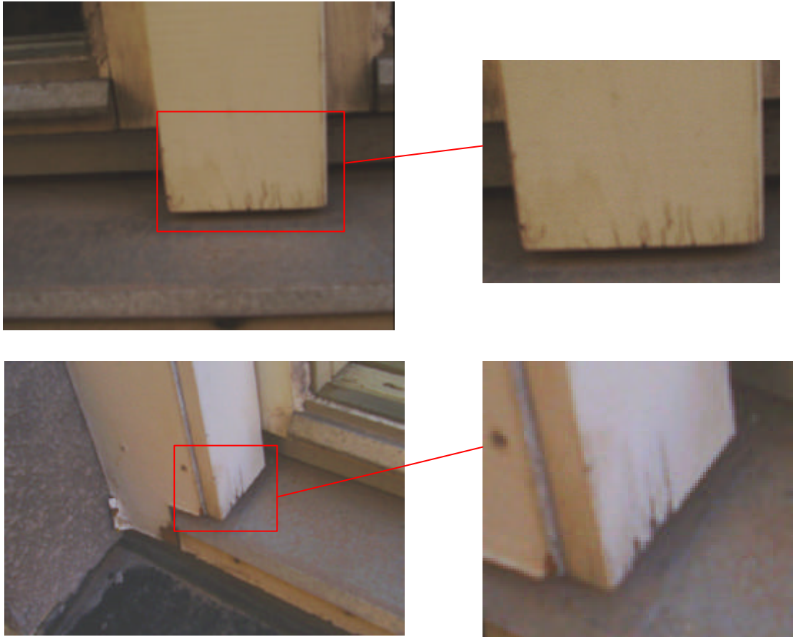
Bild 5 & 6. Begynnande fönsterskador på cirka 15 år gamla fönsterkonstruktioner.
