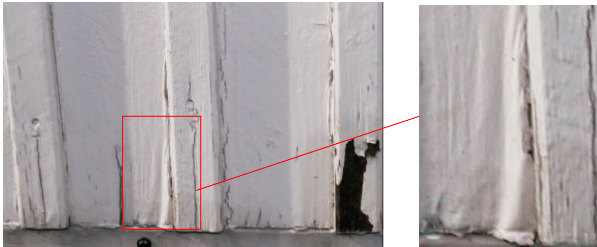
Bild 1. Färg som släppt från fasaden.
